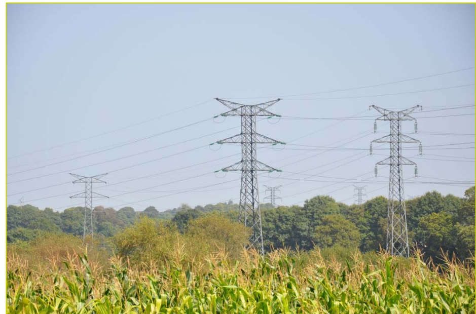
# Réseau RTE - Melgven
