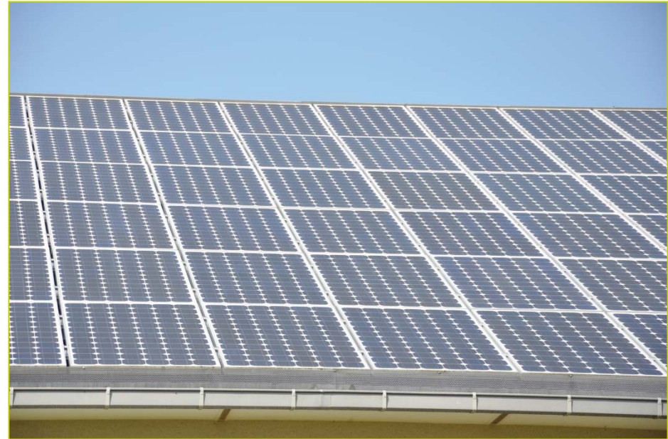
# Toiture solaire photovoltaïque - Trégunc
