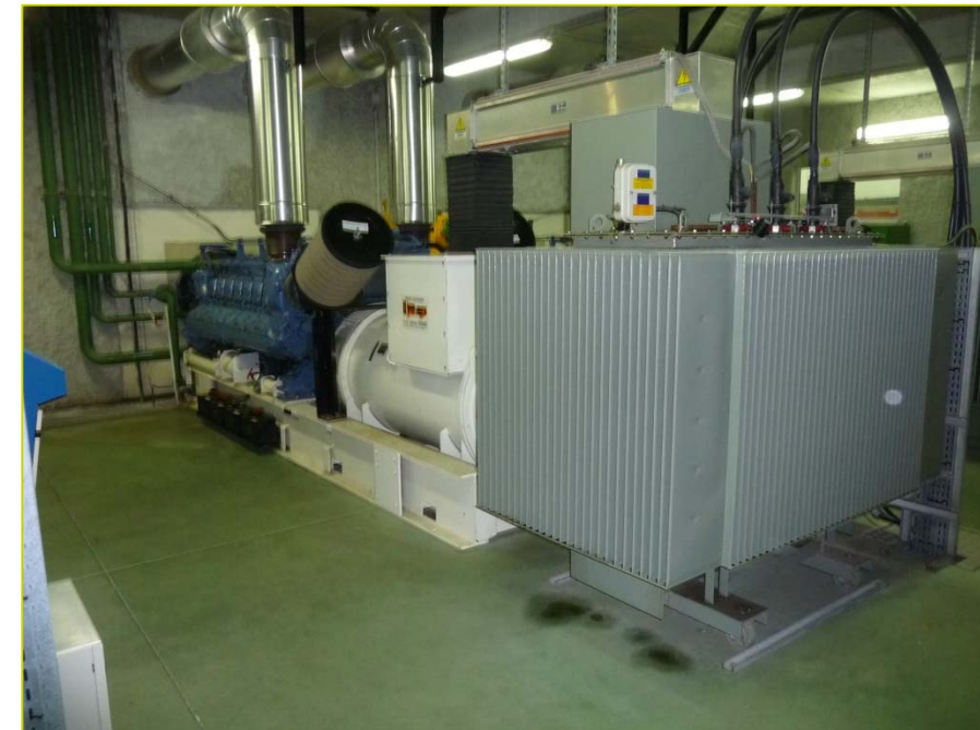
# Centrale thermique d'extrêmes pointes – Melgven
