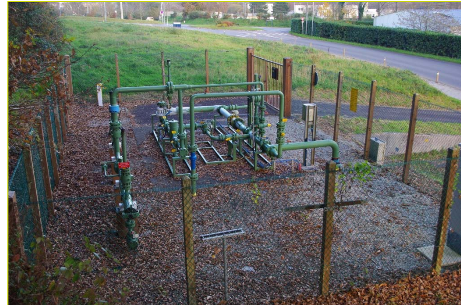
# Poste de livraison GRT gaz – Châteaulin
