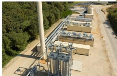
biogaz à partir de déchets
